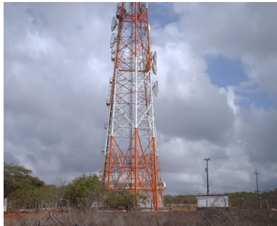
Torre auto-portante pesada 70 metros de altura
