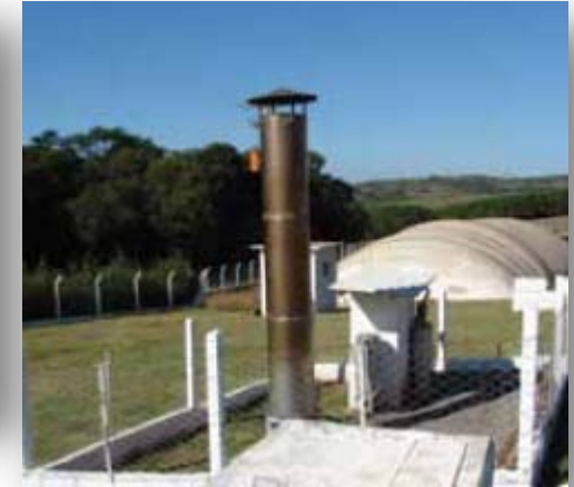
● Uso de biodigestores
